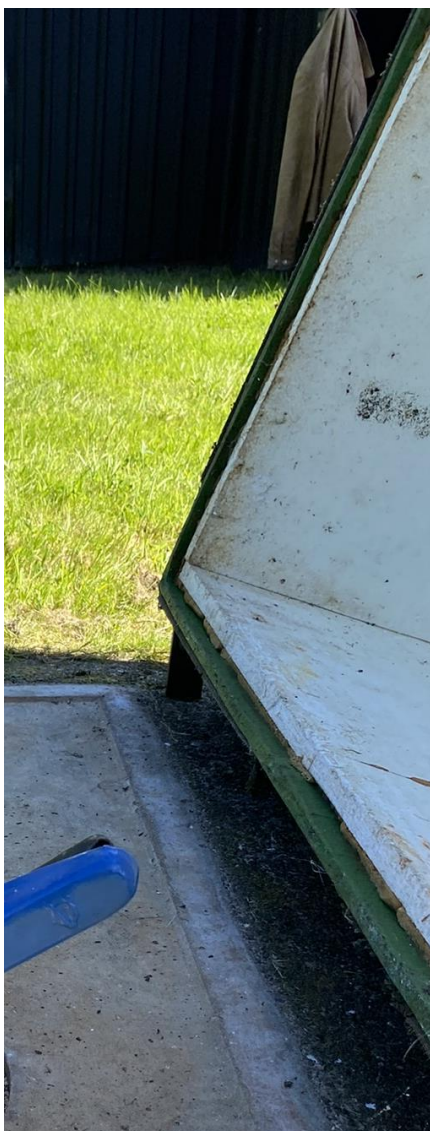
Foto 1 – Gummiliste er væk ved boring 86.1671 og begyndende skrællet af ved boring 86.2223
